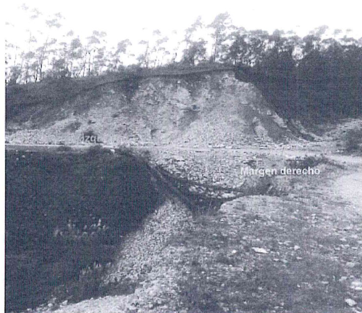
Foto 2: Se observa el estado de la vía
