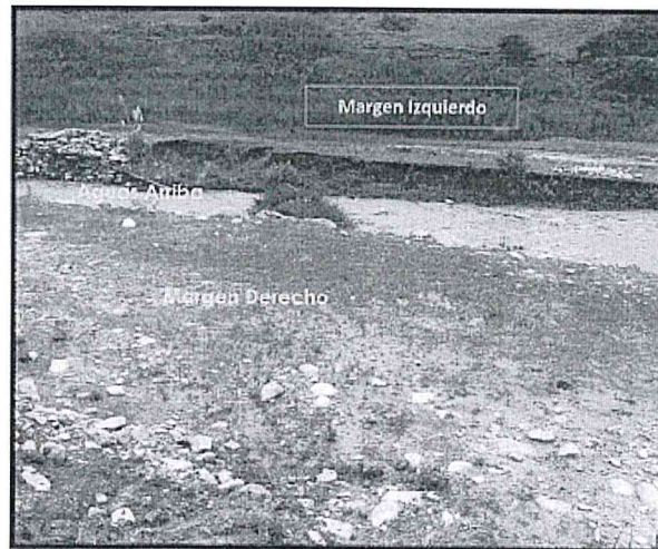
Foto N°04: Condiciones de la zona de intervención poco adecuadas
