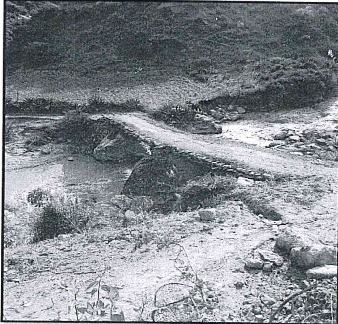
Zona del puente en mal estado
