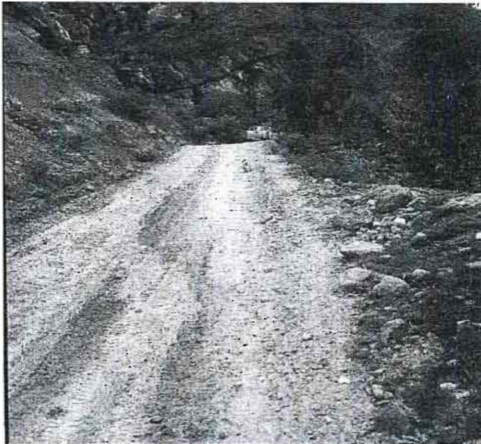
Fotog. 2. Se aprecia el acceso, de afirmado en malas condiciones
