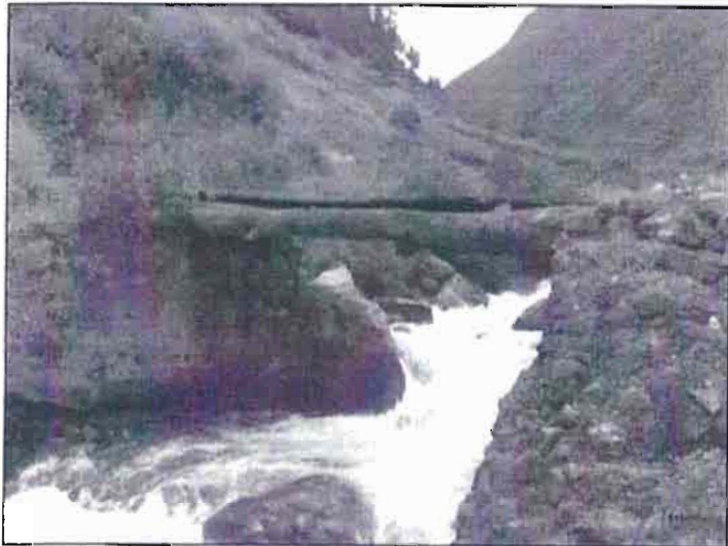
Fotog. 01: Puente Chacchan, vista panorámica, las maderas que soportan el tablero están en mal estado
