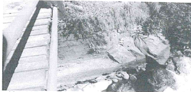
Vista del Estribo de concreto armado con problemas de socavación
